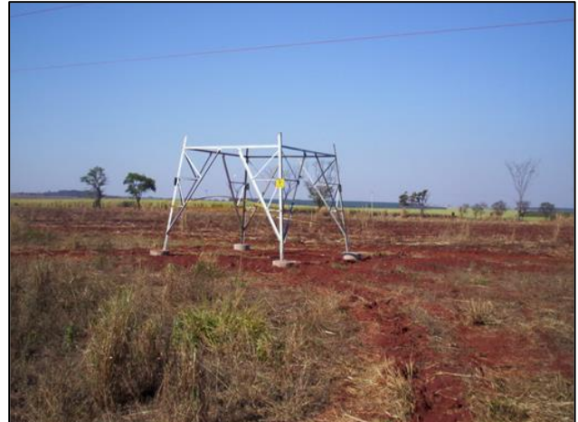
Figura 7.6. Vista de uma base montada e nivelada ilustrando o total aproveitamento do volume de terra retirado. Foto: CPFL
