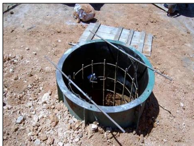
Figura 7.4. Vista de uma cava com a armadura de concreto colocada. Foto: CPFL
