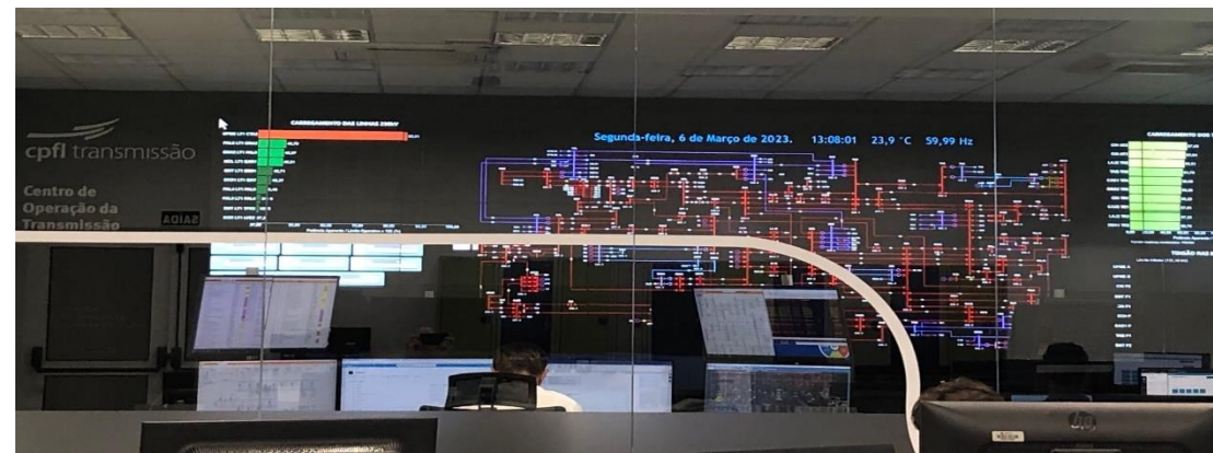
Centro de Operação da Transmissão – Porto Alegre
