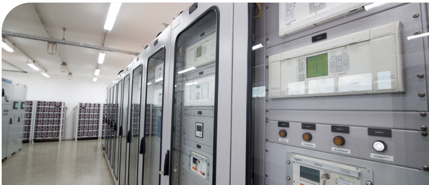
Instalação da CPFL Piracicaba
